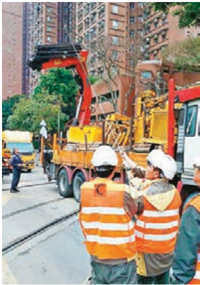
■屯門一輛吊雞車撞毀輕鐵電纜，工人到場搶修。
