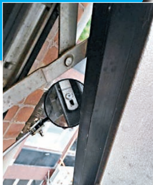
■樓齡10年以上住宅有九成使用鋁拉釘，容易出現氧化及缺漏。
