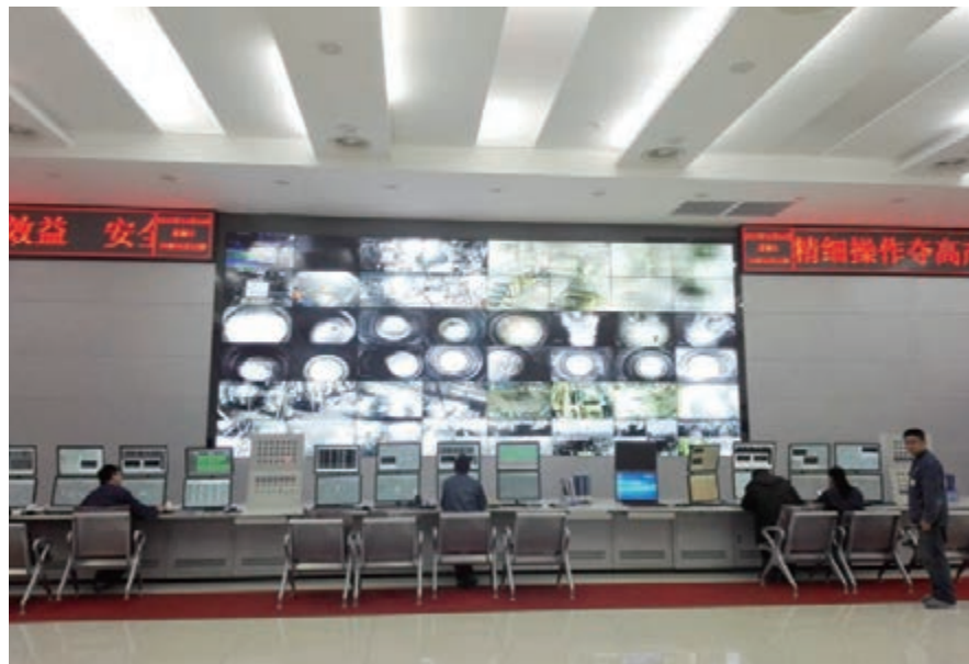
吉林石化合成橡膠廠中控室
