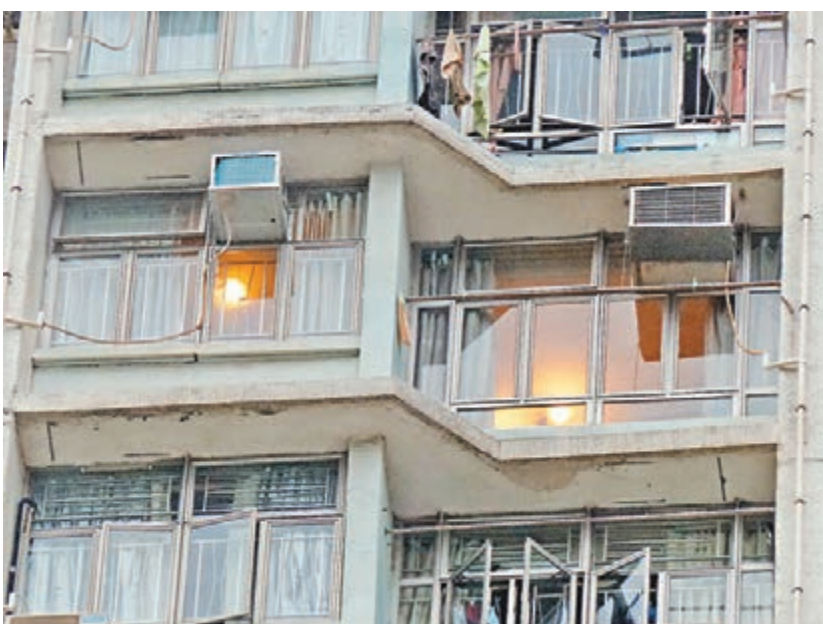
墮樓老婦的住所廳內未安裝窗花。
