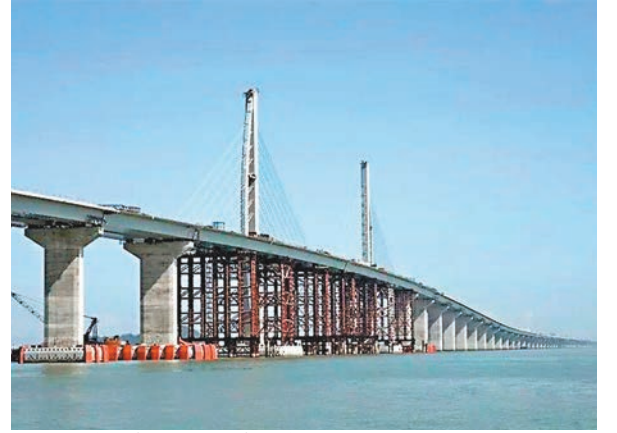
港珠澳大橋追加撥款終在工務小組主席「剪布」下,順利表決通過。圖為興建中的大橋工程。 資料圖片
