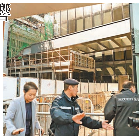
立法會大樓正門外維修中的鋼簷篷,昨日上午10時許意外下墜,幸沒人受傷。 梁祖彝攝
