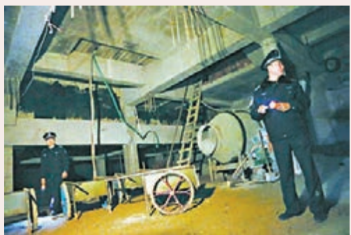
■北京非法挖掘的地下停車場。網上圖片
