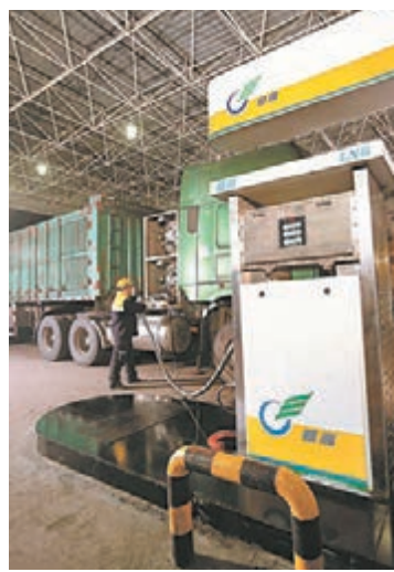
易高營運中的車用加氣站共18座,建設中共41座。
