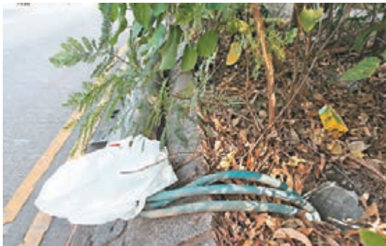
■鑽石山大磡道發生倒塌電燈柱「連根拔起」。
