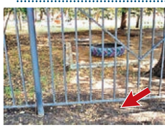
鐵閘下挖坑洞
