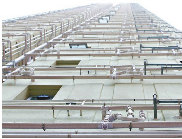
房屋署證實，4個總承建商，在提交前提交的測試報告，均稱焊料不含鉛，在快速測試下，均為燒焊位出事。
