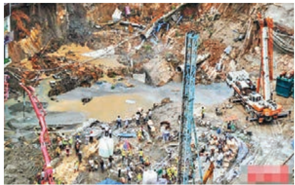
城軌工地塌場現場出現一個300平方米大坑。網上圖片
