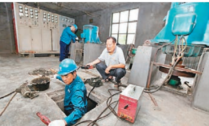
山東農民環保發電 山東省棗莊市西王莊鎮付灣村農民葛明宇(右)2002年自籌資金100多萬元，在村西的河道上興建了一座小型水電站，利用河道的自然落差，引入污水處理廠達國家一級排放標準的「出水」和河水發電。圖為維修員幫助葛明宇維修發電設備。 華新社
