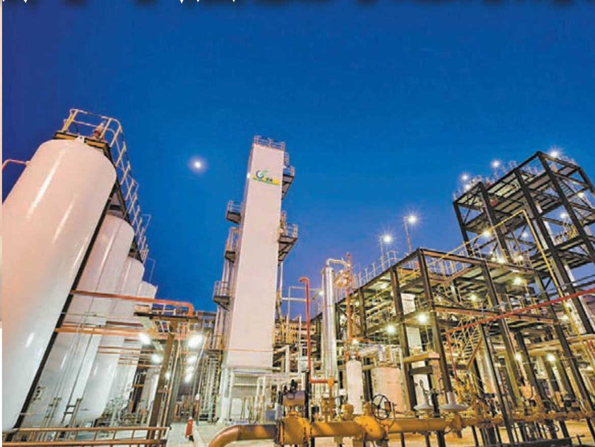
中華煤氣20年來在內地開拓逾150個項目，圖為山西液化煤層氣廠。
