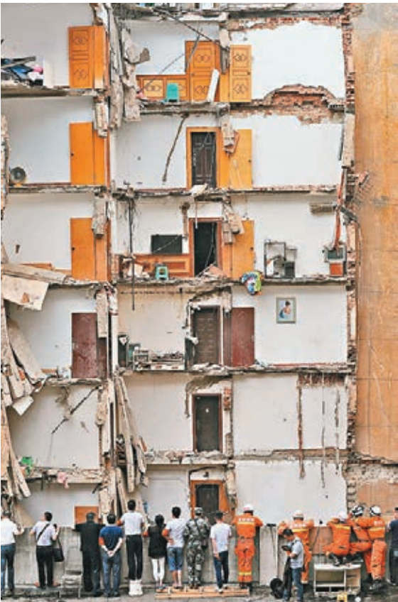
■發生垮塌的住宅樓已露出主體結構。 新華社
