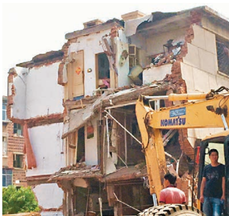
發生爆炸的三層居民樓一側已完全坍塌，救援工作正在展開。 本報遼寧傳真
