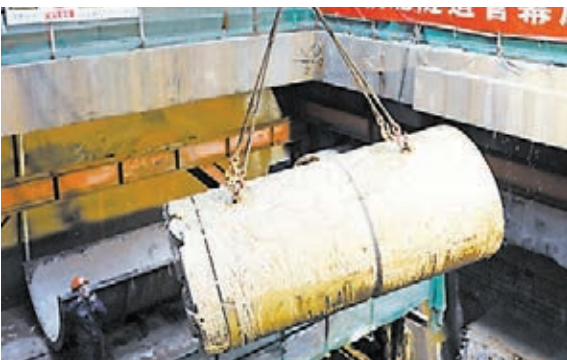
■超大曲線管幕群成功穿越拱北口岸，標誌着拱北隧道管幕施工順利完成。本報珠海傳真
