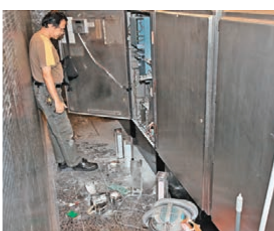
維修技工拆出冒煙售票機零件，以了解事故原因。
