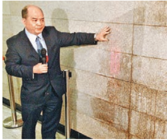
■香港大學站B2地下通道升降機大堂牆身出現滲水，李聖基指情況不罕見。 陳敏婷 攝
