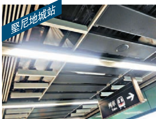
■B出口天花滴水，港鐵在假天花內設置大防水膠布盛載水滴。 陳敏婷 攝
