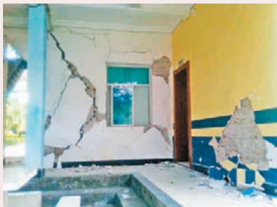
地震造成房屋出現裂縫。本報雲南傳真
