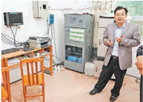
新豐縣污水處理廠的監控室。記者帥誠 攝
