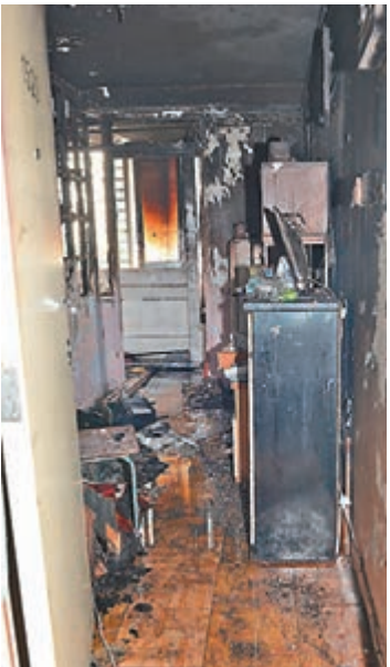
▲荔景邨景仰樓發生洗衣機起火單位嚴重被毀。
