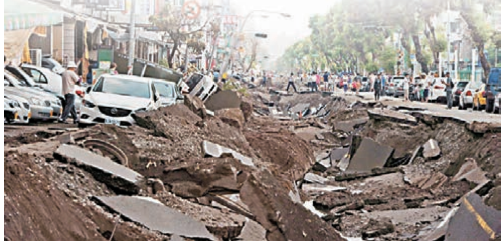
■高雄「7·31」氣爆現場出現大規模地陷。資料圖片
