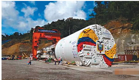
■中國水電在厄瓜多爾承建的科卡科多—辛克雷水電站發生塌方，造成13人死亡。網上圖片
