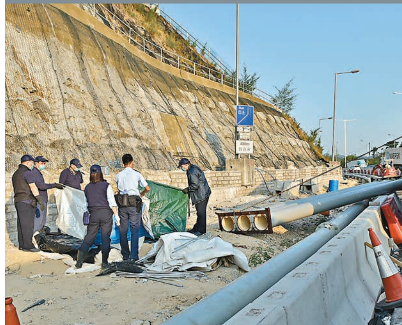
水喉工遭鋼管砸死，警員將遺體覆蓋待查。
