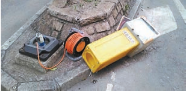
■紅棉路與夏慤道交界對開一個安全島燈箱，被人非法接駁一個約30米長的電線拖板。
