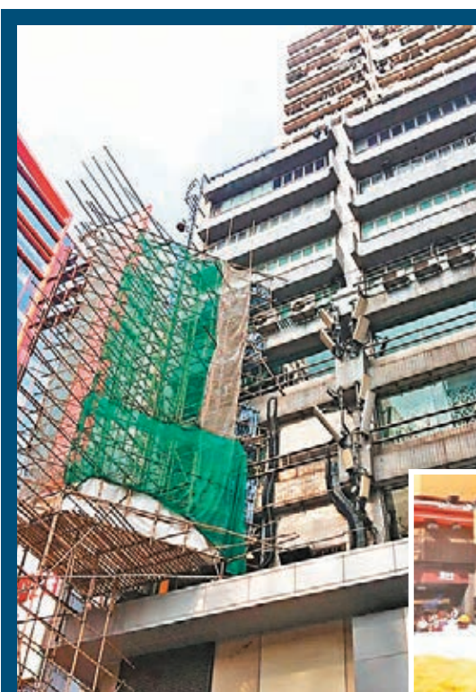
圖為案發現場大廈外牆。
