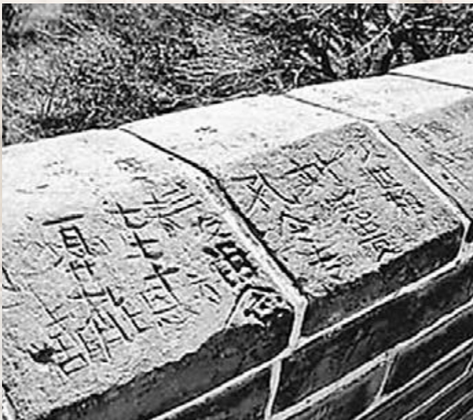
■長城的城牆慘被遊人刻字破壞。
