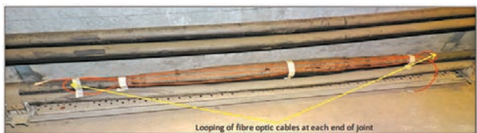
為香港一間主要的電力公司的電力系統鋪設分佈式光纖
