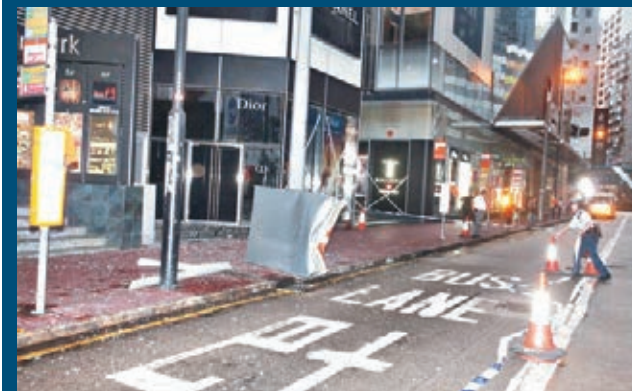
■銅鑼灣軒尼詩道希慎廣場有玻璃幕牆不敵強風塌下。
