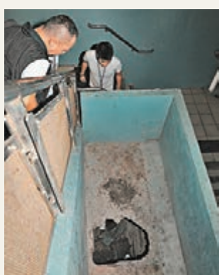
小西灣邨商場跌傷警長是踩穿梯間天井木板墮下。
