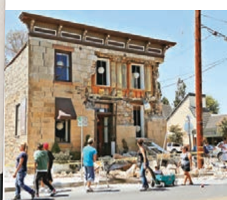
一幢建築物的磚牆倒塌，露出木製內壁。
