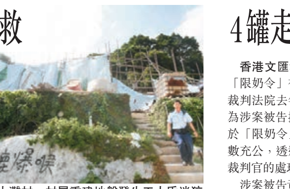
■西貢大灘村一村屋重建地盤發生工人昏迷猝死，警員到場調查。
