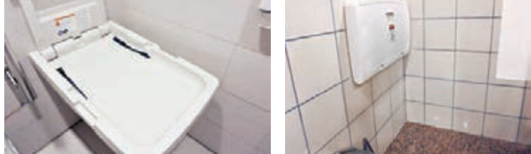
30%的換片位置沒有圍欄或凹槽，容易構成危險。 有些女洗手間內只設有育嬰
