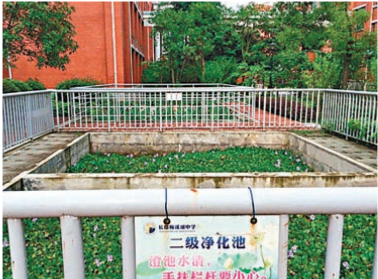
■長沙湘江新區長郡梅溪湖中學內的人工濕地污水處理系統，日處理污水200噸。 本報湖南傳真
