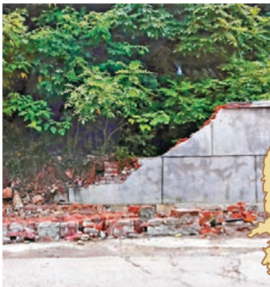
■湖南衡陽某軍事管理區外的部分圍牆已經倒塌。 中新社
