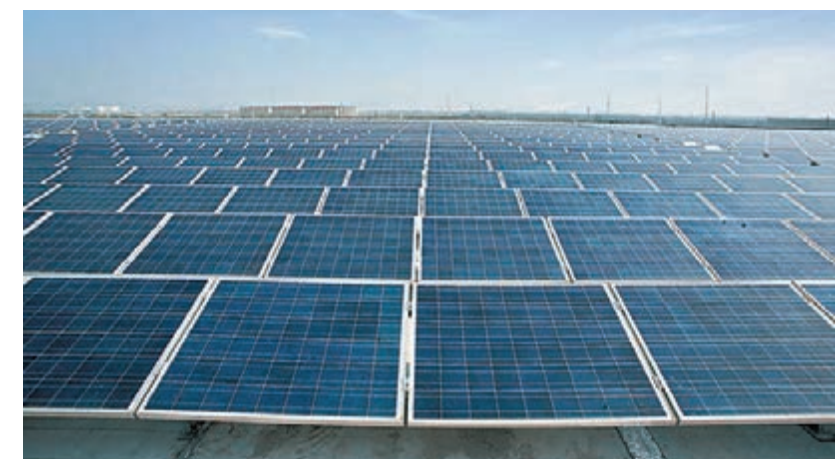
鹽池阜寧屋頂光伏發電系統
