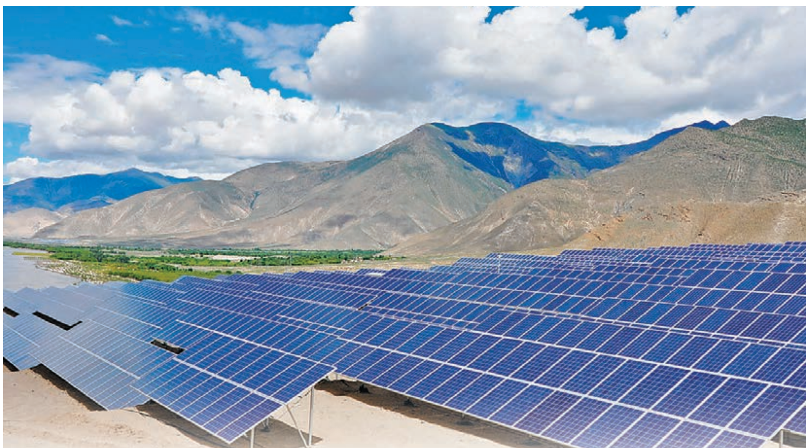
集團在西藏桑日的光伏發電項目
