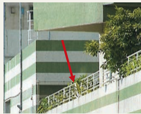
■屯門慧豐園平台一截欄杆被墮樓男子壓毀。
