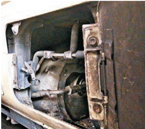
■設於司機位後車身近底部的氣缸，疑遭硬物擊中出現長裂痕。
