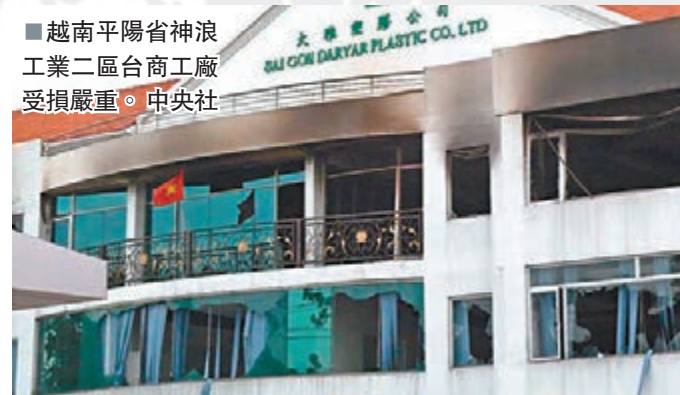
■越南平陽省神浪工業二區台商工廠受損嚴重。 中央社
