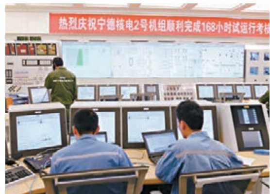
寧德核電站2號機組完成168小時試運行。
