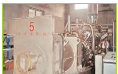
■機房內發電機組
