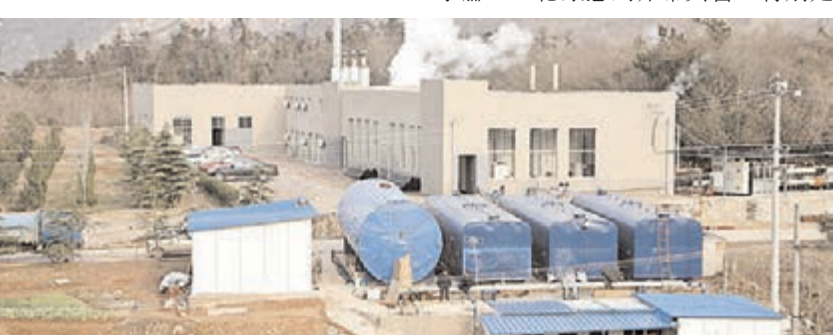
■南京轎子山垃圾場沼氣發電項目全景圖冷卻塔
