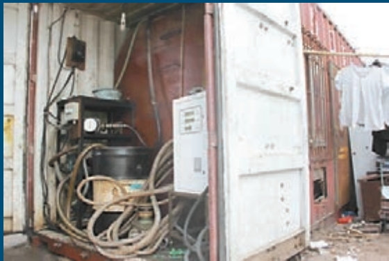
■違法加油設備藏匿在貨櫃內，簡陋且無任何消防配備。
