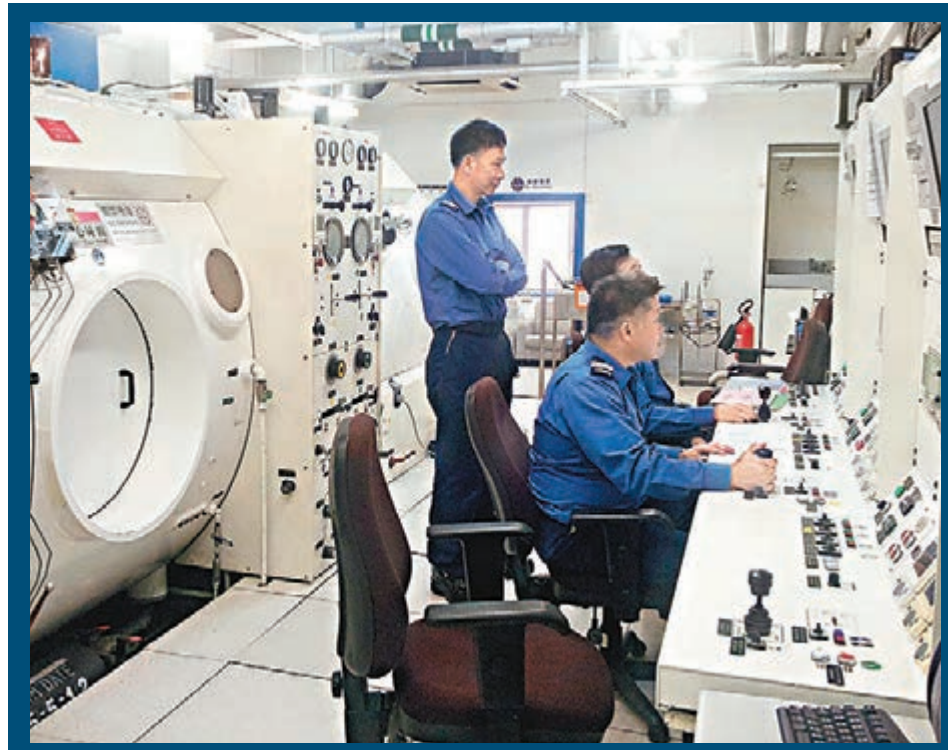
消防潛水行動及訓練支援專隊在消防處昂洲加壓室操作加壓艙，為患者進行高壓氧治療。
