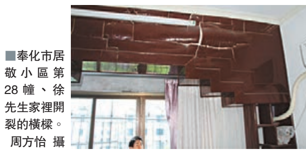
奉化市居敬小區第28幢、徐先生家連開裂的橫樑。周方怡 攝
