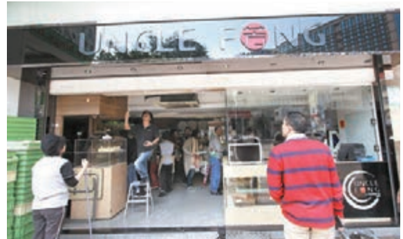
閣樓燈飾店爆水管水浸,殃及地下餅店,職員忙於清理天花水漬。
