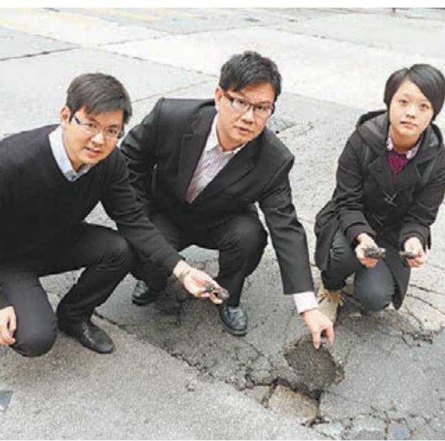
路中心新補瀝青路面修補不足3星期，已出現凹陷、破裂。吳芷芊攝
