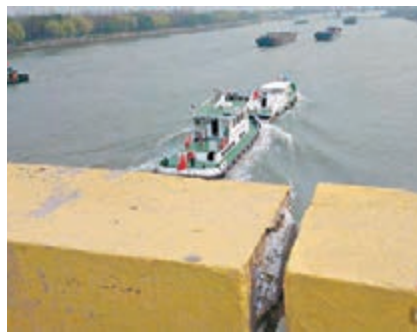
■開裂的橋墩。中新社
