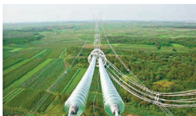
■重慶特高壓工程。 本報重慶傳真
