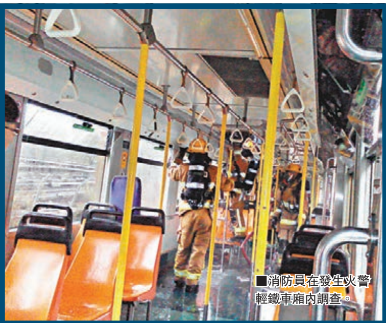
■天水圍行駛中車頂冷氣出風口着火輕鐵濃煙湧現及有明火。
